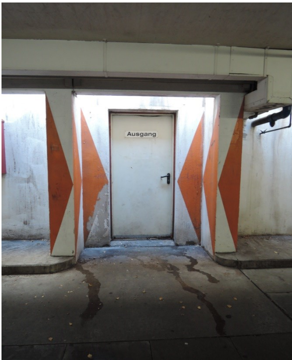
Die Türen sind stark verrostet und verschmutzt.
