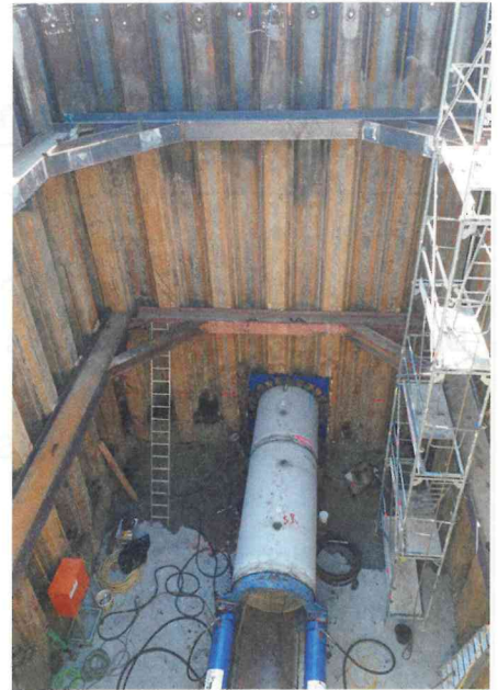
Bis in 9 Meter Tiefe, bei einem Durchmesser von 1,5 Metern, musste ein Mischwassersammler eingetrieben werden.
